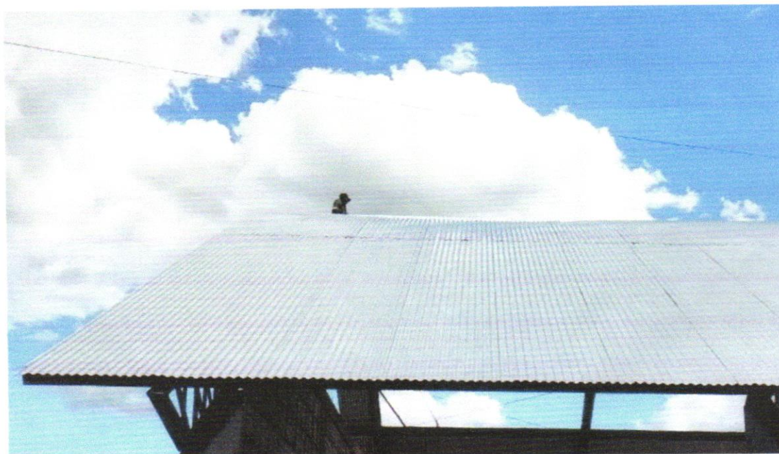
IMAGEM 03 - Telhamento com telha metálica em chapa de aço galvanizado natural ondulada e=0,5mm
